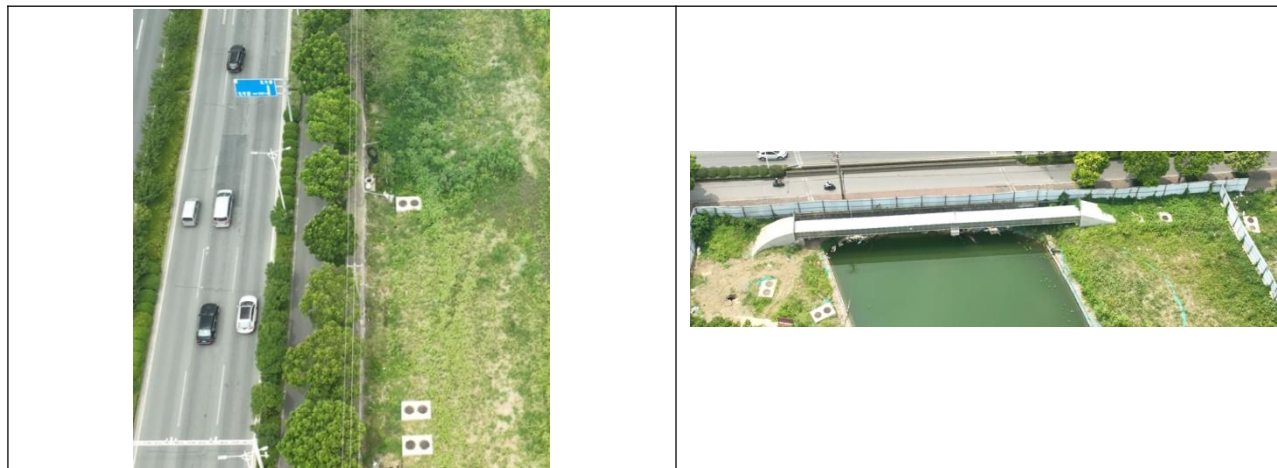
110kV 电缆线路生态恢复示例
